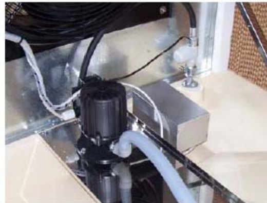
- pompa de recirculare
